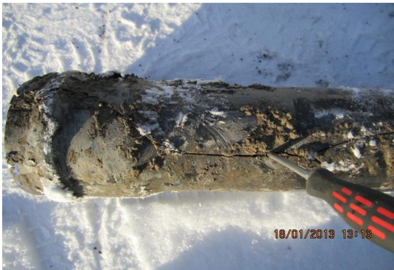
Bildet viser sprukket vannrør ved Bjørkebekk
