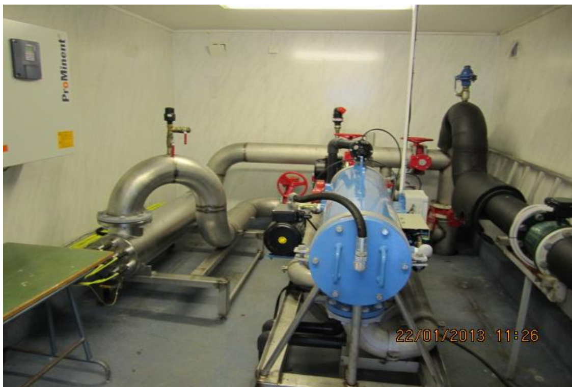
Bildet viser vannrenseanlegget innvendig
