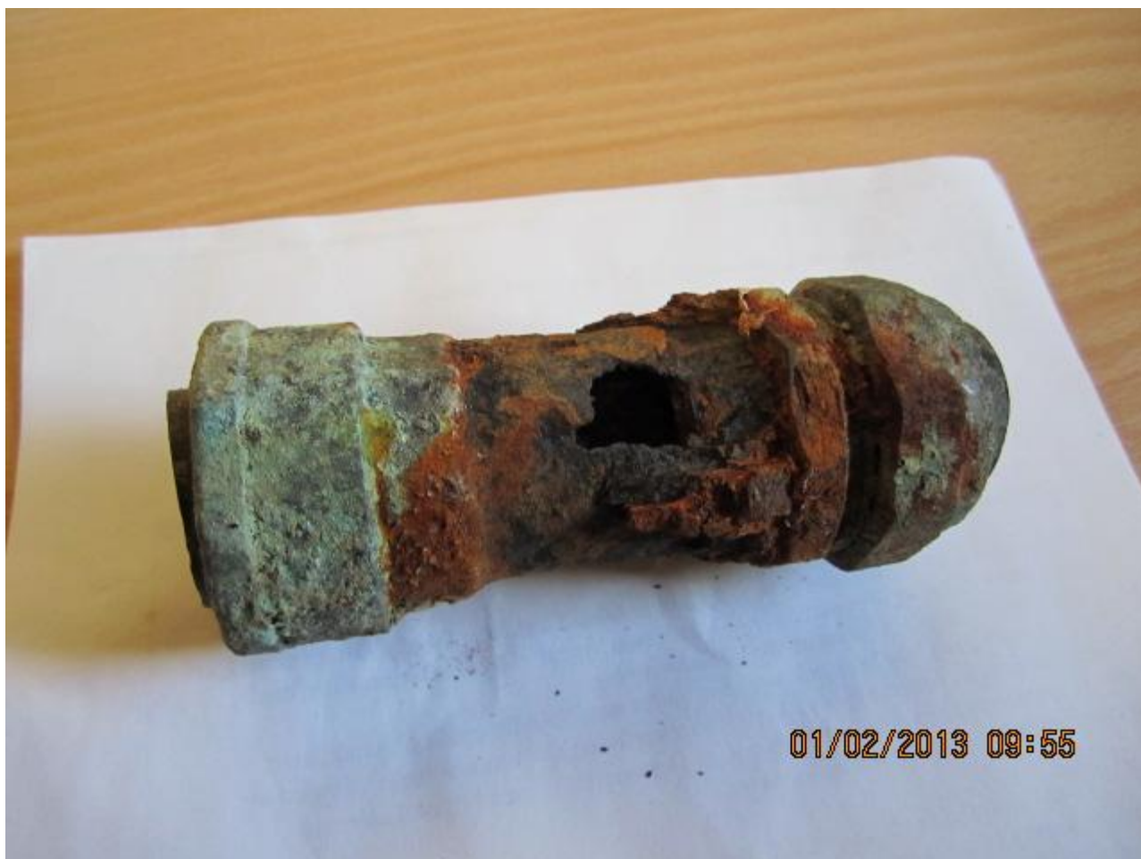
Bildet viser årsaken til en vannlekkasje i Lillebyfeltet
